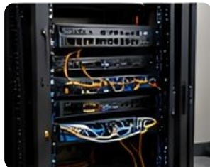
Tủ rack & đi dây
